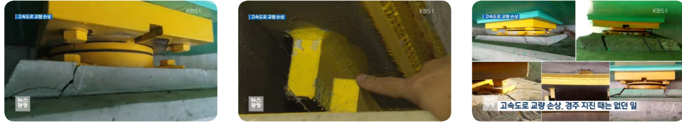
<무수축 모르타르 파손> <받침 빼기 파손> <무수축 모르타르 및 빼기 파손>
