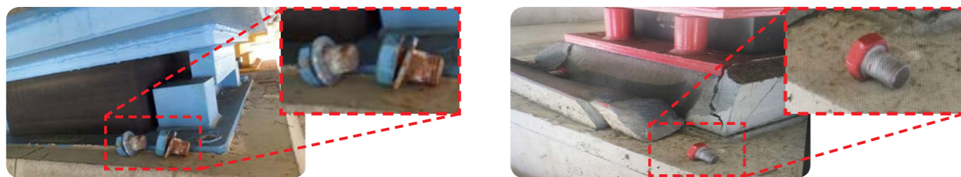
▲ 지진 시 볼트 파괴 및 탈락 사례
