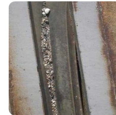
배수 시트 파손 및 찢어짐
