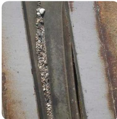
배수 시트 파손 및 찢어짐
